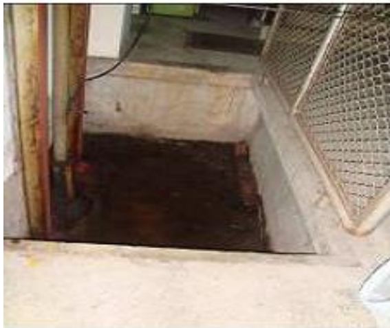
地下室之升降梯孔積水
