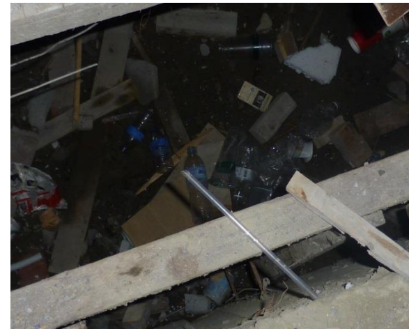
建築工地廢棄物堆積處
