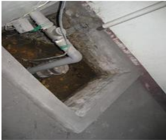
地下室儲水槽
